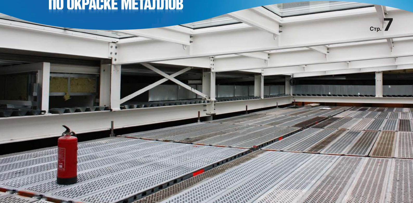
Окраска стальных конструкций торгового центра Klivvi выполнена с использованием огнезащитного водоразбавляемого покрытия вспучивающегося типа ХЕНСОТЕРМ 4 КС, класс огнестойкости R60.
